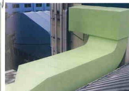
ダクトの放熱防止
