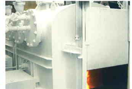
保温、火傷防止、劣化防止
