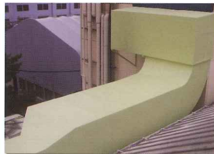
ダクトの放熱防止
